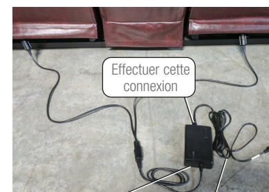
Transformateur électrique Cordon d'alimentation de 120 volts
